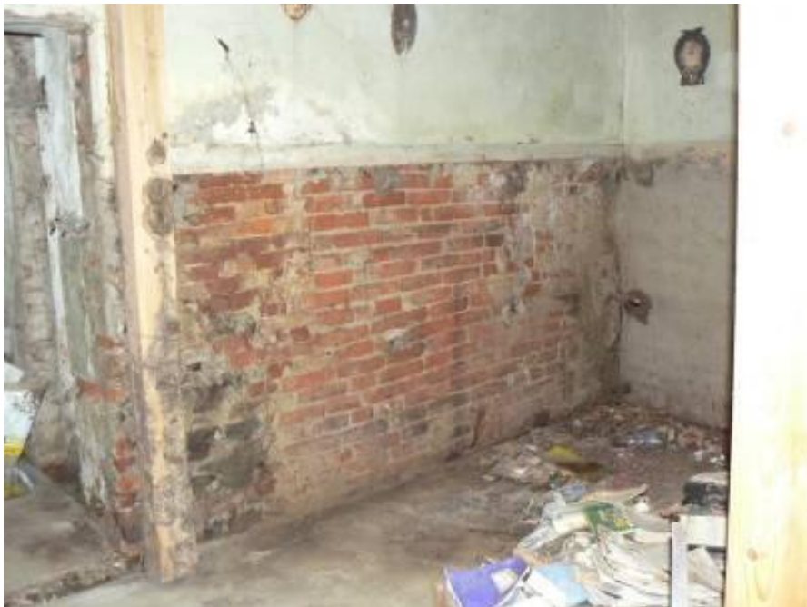
...und die feuchte (nein nasse) und schimmelige Holzlamperie zu entsorgen
