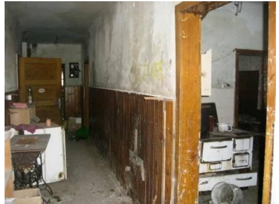
links der Gang - rechts die "Küche" – sieht ziemlich schlimm aus :(
