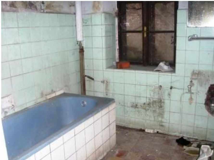
ebenfalls aus dem Inserat: absolut ehrliche Bilder über den Zustand des Hauses
